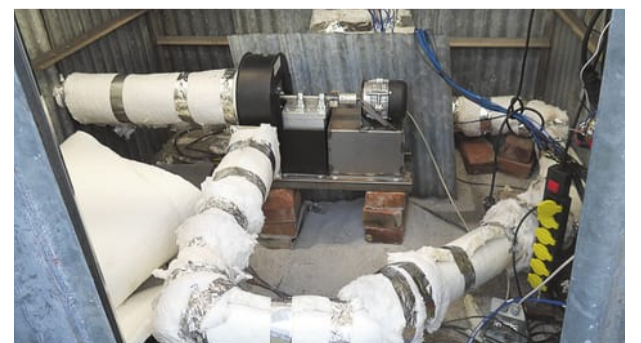
Luften värms upp och pumpas ner i sandgropen. Värmen kan sedan plockas ut under vintern.
